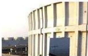
FRP Fan Stacks
